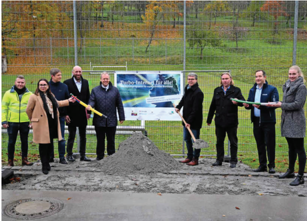
Der Startschuss für die Verlegung der Glasfaserkabel fällt in Zaisenhausen. Hier haben bereits 95 Prozent der Bewohner einem Hausanschluss zugesagt. Foto: Katrin Draskovits
